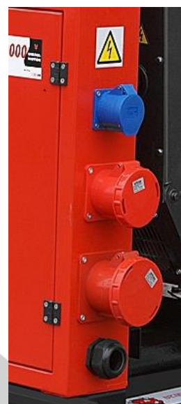
Rozdzielnia elektryczna wyposażona w przyłącza o wysokiej klasie izolacji (IP-67).
