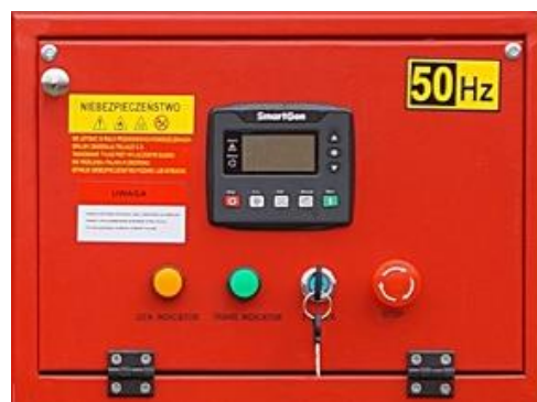
Panel sterowania urządzenia wyposażony w elektroniczny sterownik „Smartgen” HGM-420N, stacyjkę jednostki, kontrolki informacyjne oraz wyłącznik awaryjny.
